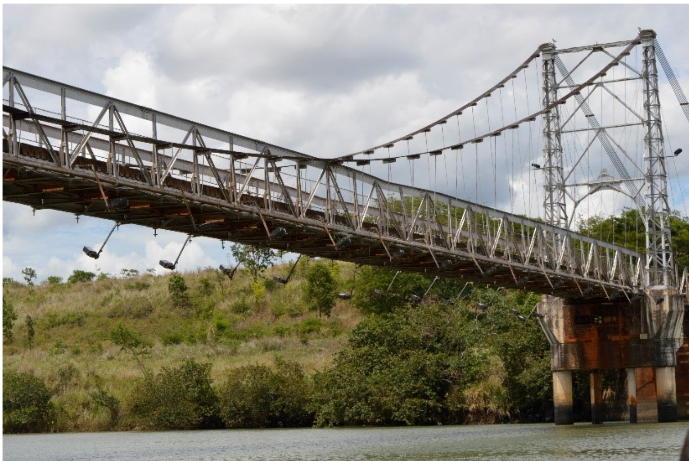
Ponte Affonso Penna será recuperada com apoio técnico da Faculdade de Engenharia Civil. (Foto: Arquivo/Feciv/UFU)
